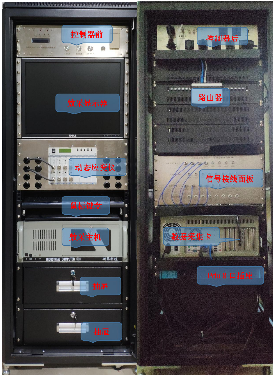
图 12:控制机柜前后实物图
